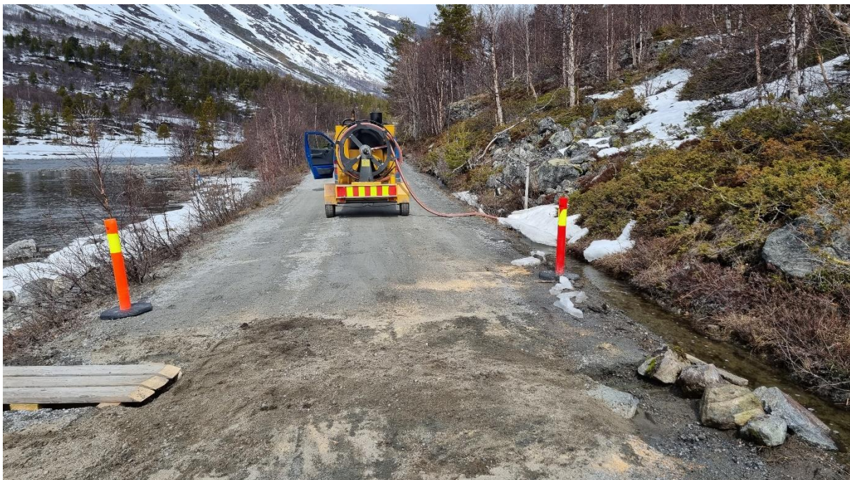
Tining av stikkrenne på Sotvegen våren 2023.
